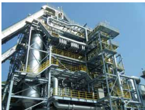
【内部循環流動床ボイラ】
